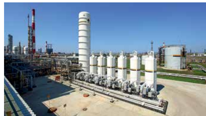
Установка короткоциклового адсорбции водородсодержащего газа на Новокуйбышевском НПЗ
